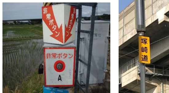
<踏切非常ボタン> <特殊信号発光器>
